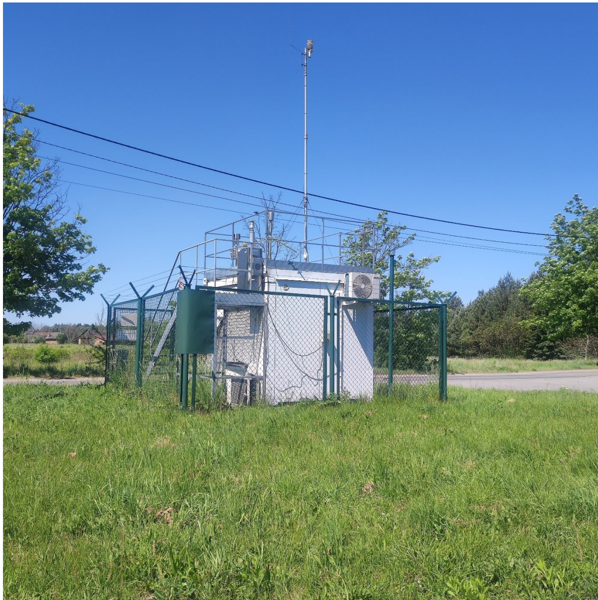
Stacja monitoringu powietrza przy ul. Szklarniowej w Nisku
